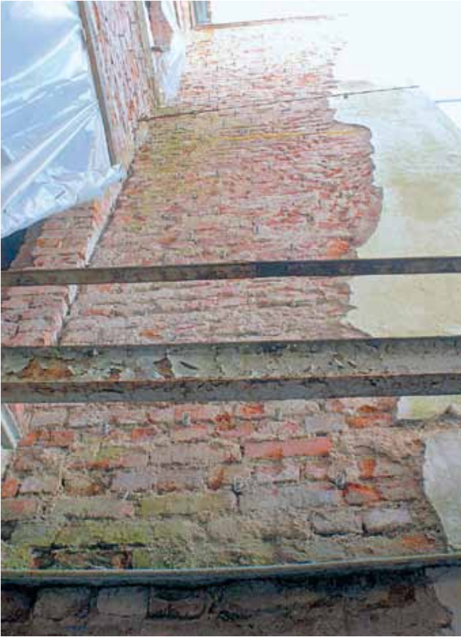
Sinnlose Behandlung der Außenmauer der mehrgeschossigen Schumann-Villa in Arzberg
