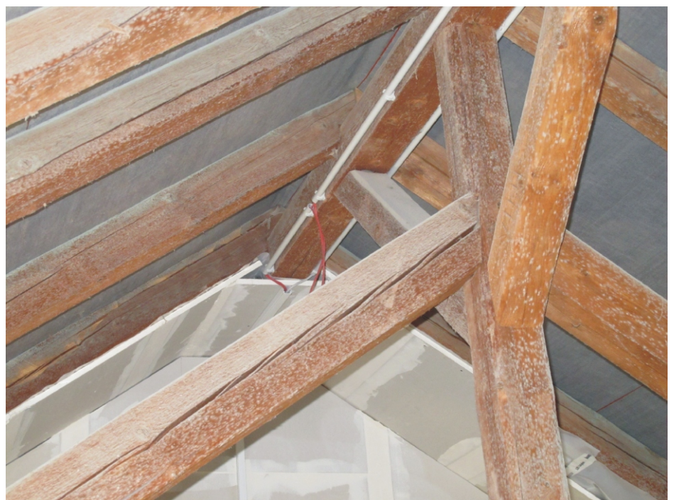
Schimmelpilzbefall im Dachstuhl
