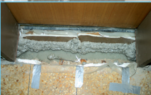
Der Zugang zu nicht befallenen Räumen wurde im Türbereich mit Montageschaum abgedichtet.
