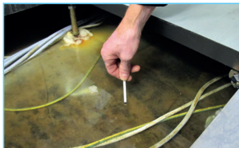
Mit Wirkstoff-Teststreifen wurde die Wirkstoffkonzentration der Desinfektionsspülung überprüft.
