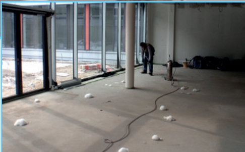
Zum optimalen Einbringen des Schaums wurden über ein Bohrraster im Abstand von ca. 1 Meter Packer gesetzt.
