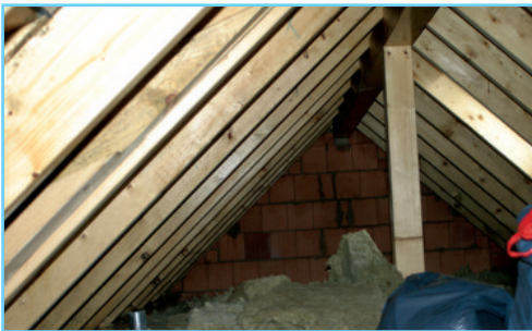
Die Dämmung sollte entfernt und erneuert werden.
