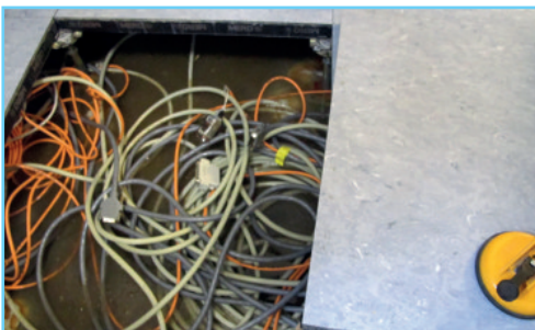
Die Installationstechnik für das CT-Gerät war im Doppelboden untergebracht.
